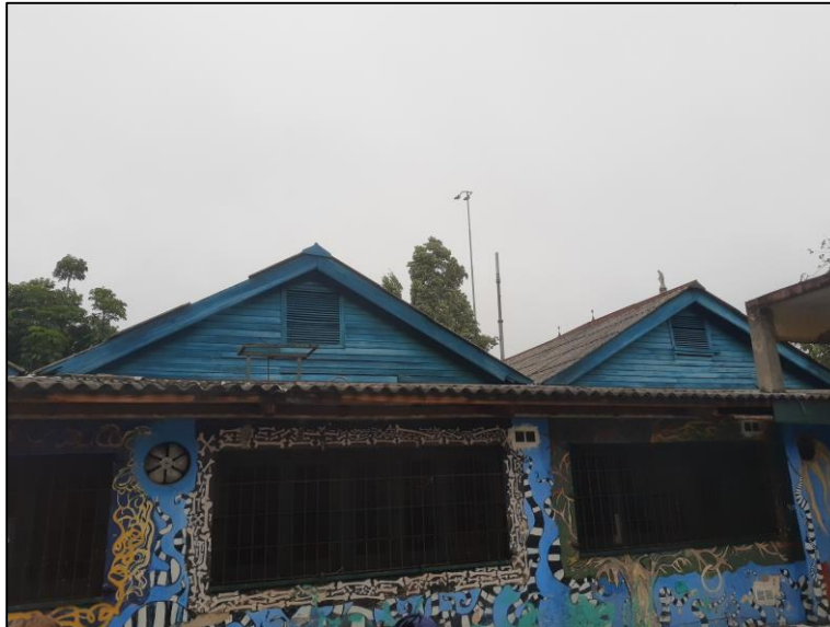
Imagen N° 1 Techo de Chapa de Fibrocemento con Asbesto
